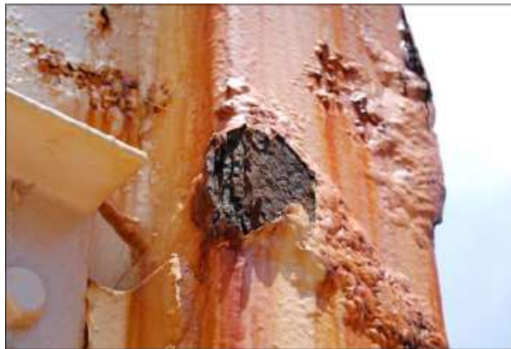
Figura 1. Corrosión en una estructura metálica. Fuente: (CEMESA, 2014)
